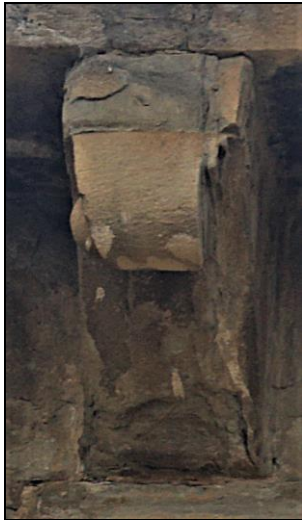
8.- Canecillo de la nave central: muro Sur
