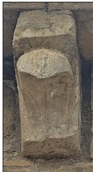
4.- Canecillo de la nave central, muro sur
