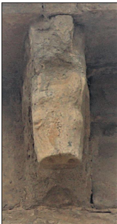
1.- Canecillo de la nave central, muro sur
