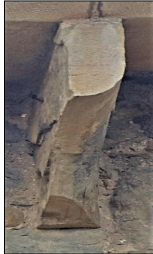
9.- Canecillo de la nave central: muro Sur
