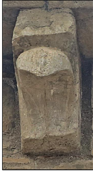
6.- Canecillo de la nave central, muro sur
