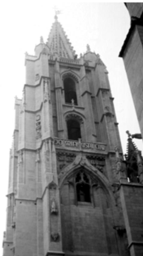
Imagen 5. La torre sur de la catedral de León presenta un evidente replanteo. Literalmente se ha "embutido" la zona alta, que sirve de base a la flecha, sobre un proyecto anterior. Este remate ha sido atribuido a Hans de Colonia.
