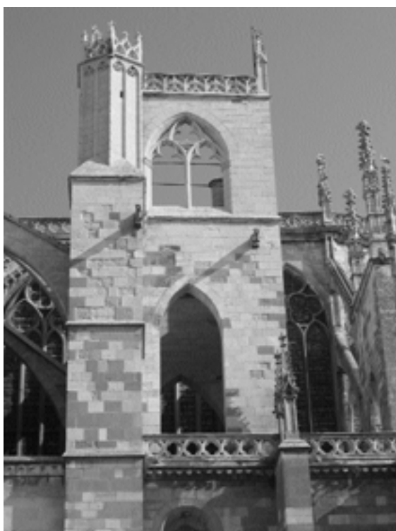
Lámina 3.- Catedral de León. Costado meridional del transepto. Silla de la Reina, detalle de las pantallas-contrafuerte del siglo XIII y remate del siglo XV.
