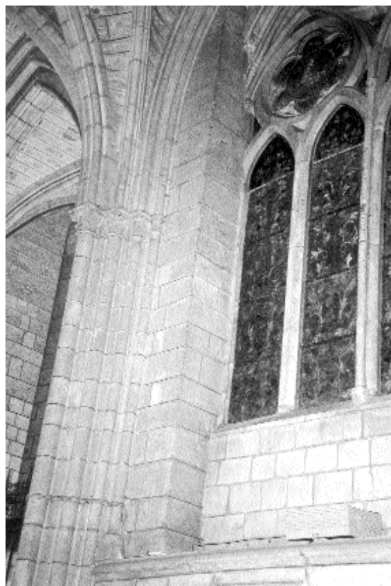
Figura 11. Interior de la nave Norte con la intromisión de la torre en la ventana.
