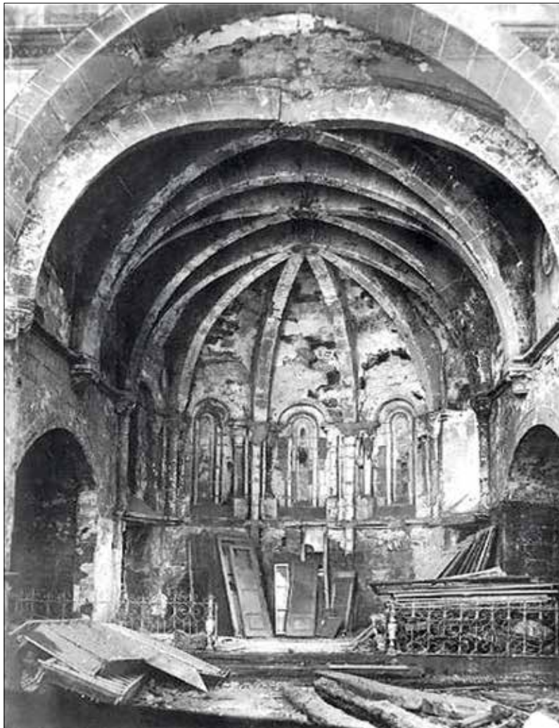
Fotografía realizada tras el incendio de 1936. En el presbiterio se aprecian los dos arcos laterales y bajo el primer ventanal del lado del evangelio la puerta de entrada a la sacristía.
