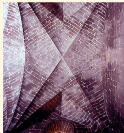
Bóveda aristada pétrea de la capilla real de Valencia. (Foto P. Alcántara)
