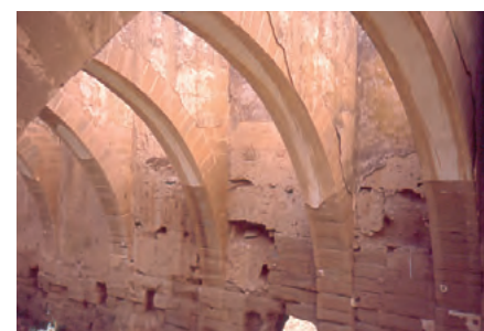
Nave arruinada del monasterio de la orden de San Juan del Hospital en Sigena, Aragón. (Foto R. Sicluna).
